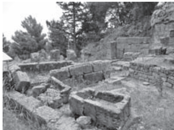
Fig. 9 – Santuario Rupestre: cedimenti e rotazioni delle strutture murarie.
