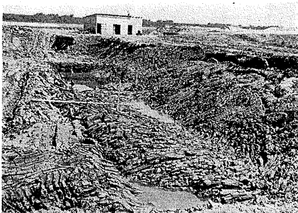
Fig. 3 - Fotografia dello scavo dopo lo scivolamento.
