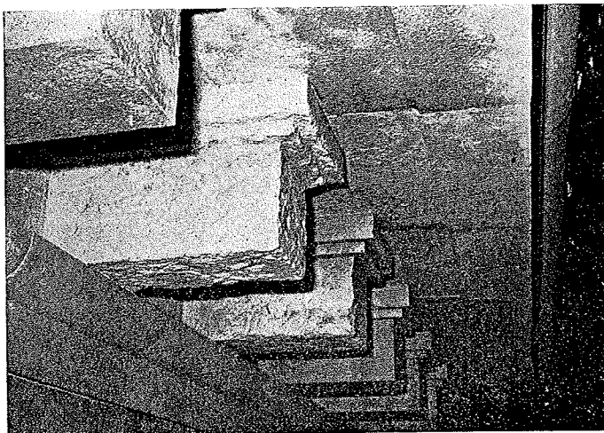
Fig. 1. - Palazzo della Provincia di Bari. Aspetto delle mensole di sostegno dei balconi dopo la sabbiatura: da notare i gravi danni subiti dalla piastra a causa dell'aggressione dovuta alla salsedine.
